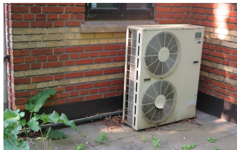
Varmepumpe ved bygningens nordfacade
