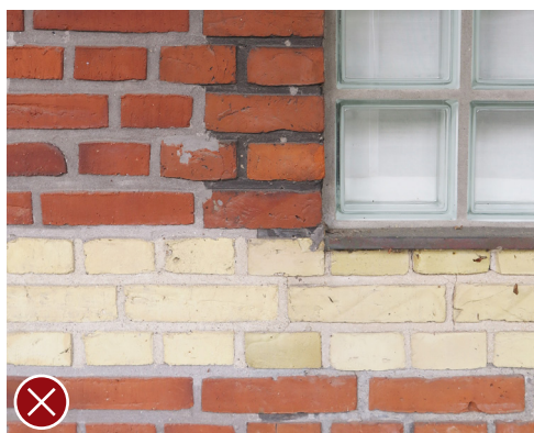
Reparation af murværk med forkert fugefarve (kiosken).
