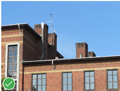
Eksisterende udluftningskanaler (sengebygningen).
