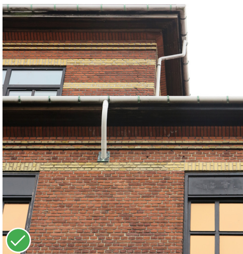
Afvanding fra tag til hovedtag, hvorfra det føres skjult ind i facaden til afløb. (sengebygningen).
