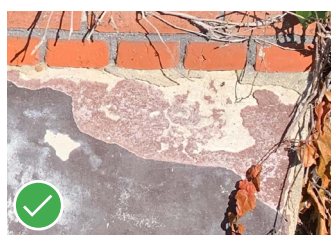
Sokkel, hvor den oprindelige indfarvede puds ses bag den nye lilla-brune maling (sengebygningen).
